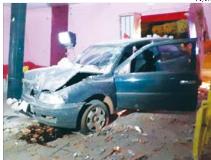
A estrutura do bar pode ter sido comprometida por conta do acidente causado por motorista embriagado
