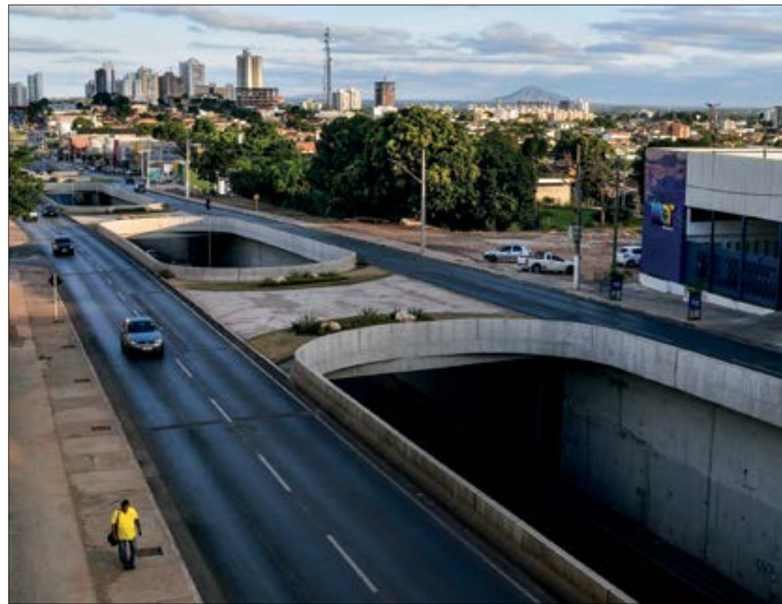
Trincheira estaria com afundamentos na pista e diversos buracos, além de paredes com infiltrações
