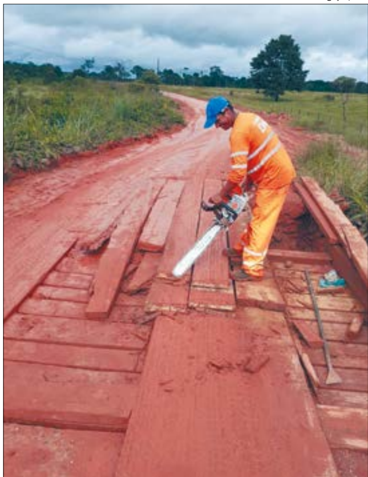
Devido à precariedade das pontes, Dnit impôs limite de carga aos caminhoneiros
