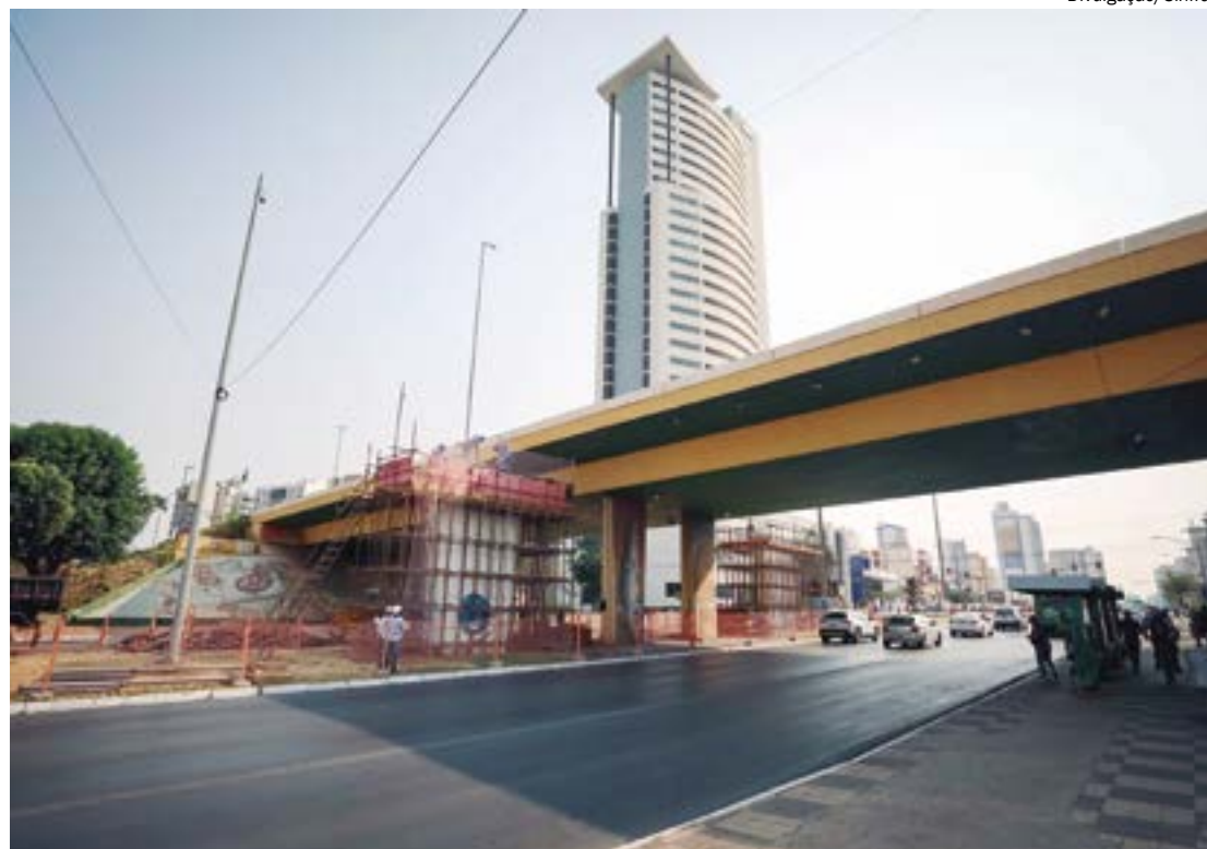
Fechamento é necessário para lançar vigas que sustentarão a ampliação do viaduto sobre a Avenida do CPA
