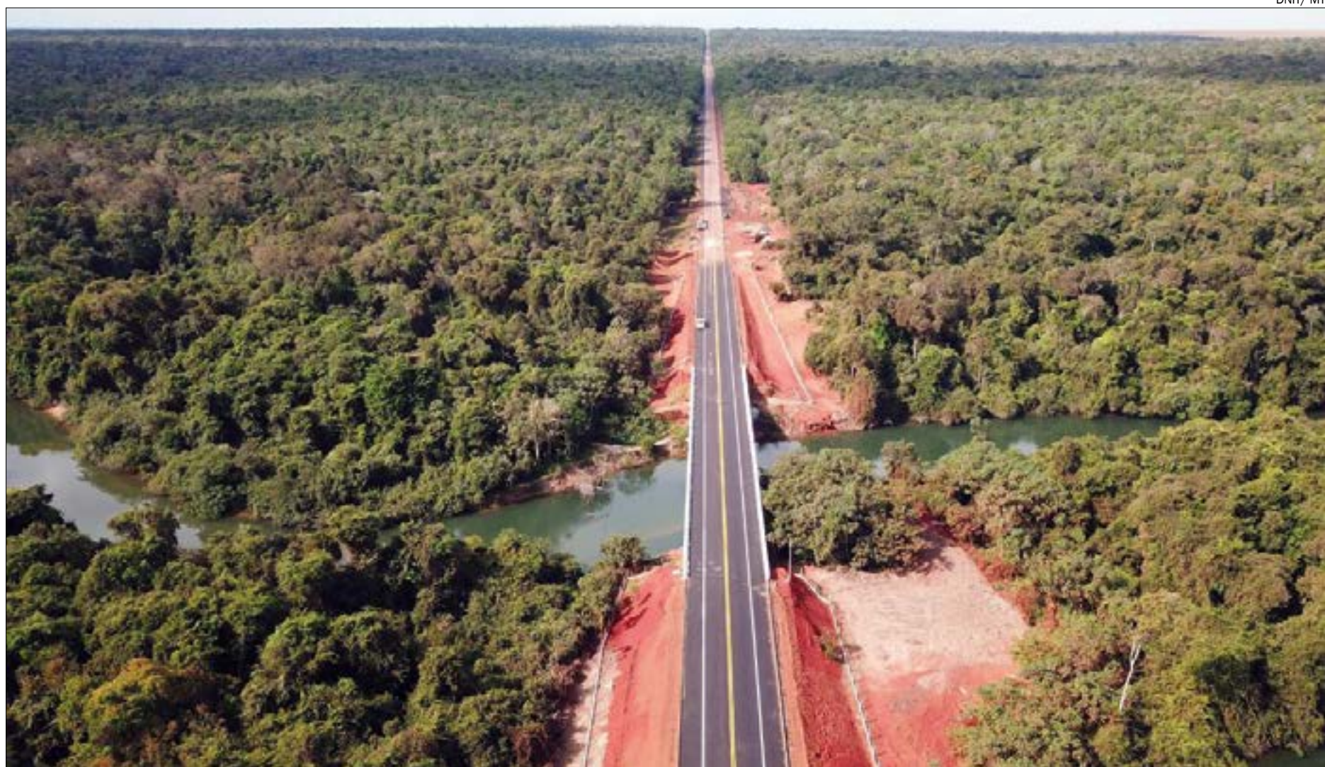
Além da conclusão das oito pontes, o Dnit já pavimentou 150 quilômetros da rodovia
